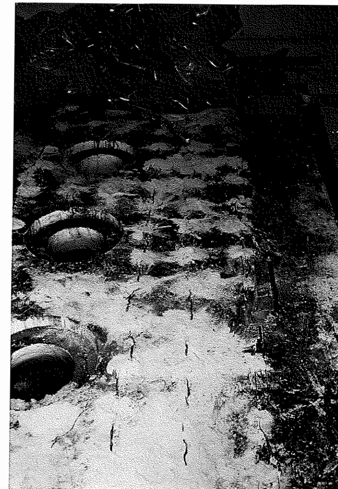
Bild Nr. 8: Rißbildung in der Zellendecke nach erfolgter chemischer Sprengung
